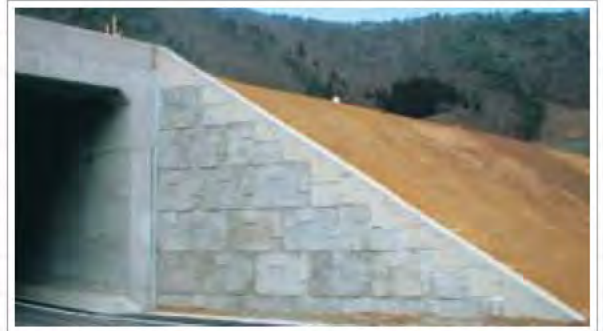
壁面材のデザインにあわせた笠コンクリート(化粧型枠使用)
