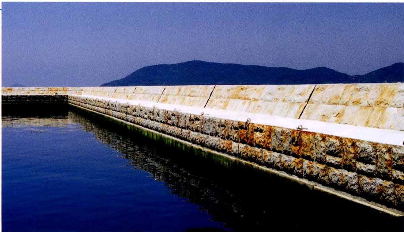
香川県 高松市河港課 浦生漁港改修事業防波堤建設工事
