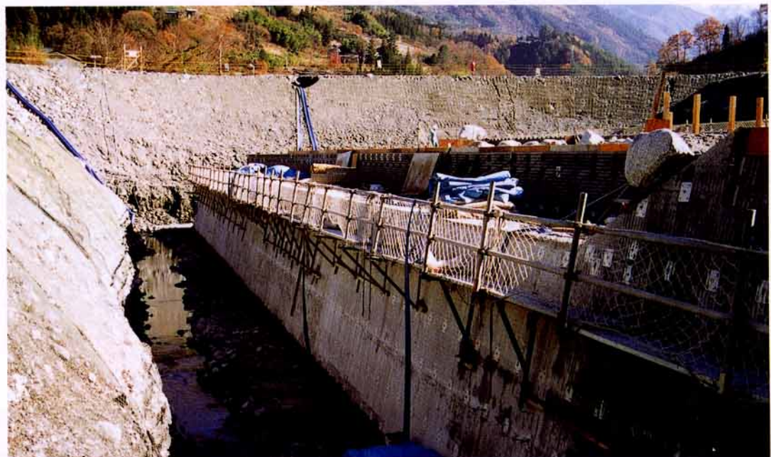
長野県 中部地建 天竜川上流工事事務所 大河原4号床固工工事
