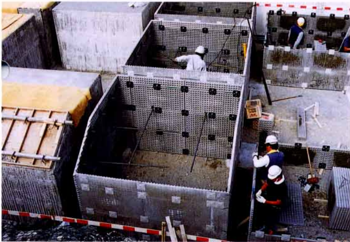
富山県 北陸地建 立山砂防工事事務所 真川下流工事用道路(根固め工事)
