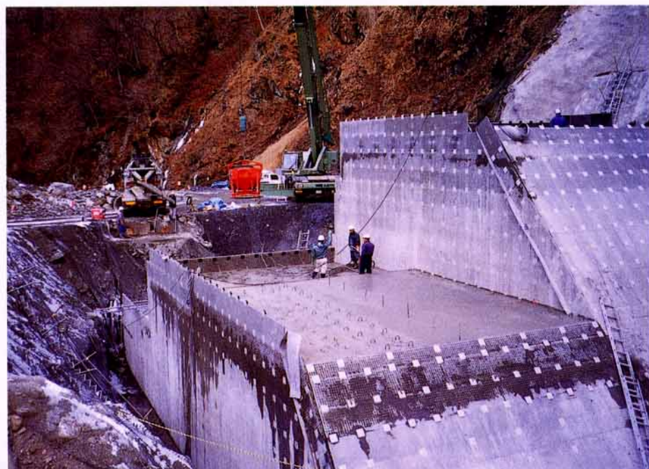
長野県 中部地建 天竜川上流工事事務所 尾勝谷第3砂防ダム
