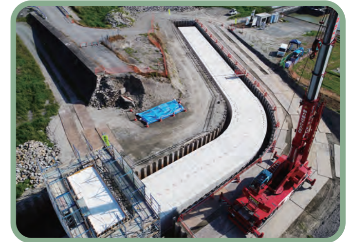
施主：佐賀県杵藤農林事務所 工事名：白石平野地区県営地盤沈下対策事業工事 サイズ：4400×1800(幅×高さ)
