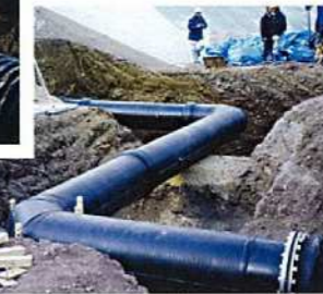
産業廃棄物処分場浸出水導水管
